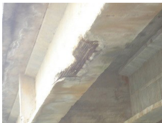
Foto 3: Detalhe de uma das vigas com rompimento da armadura principal (RISCO DE COLAPSO DA ESTRUTURA).
