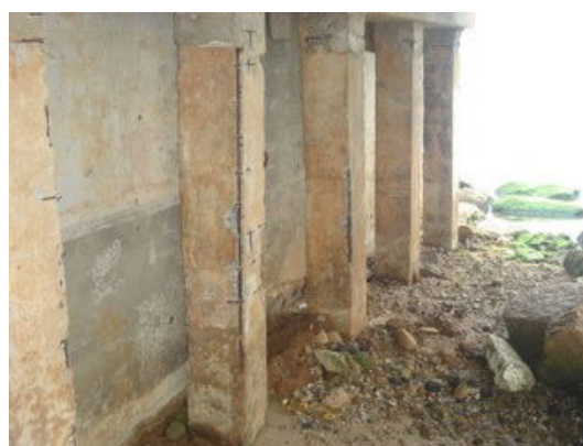
Foto 2: Pilares (meso estrutura) - desagregação do concreto e corrosão de armadura.
