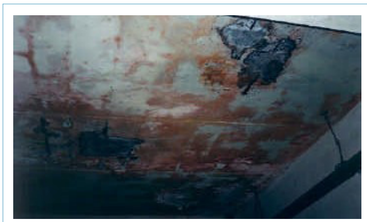
Corrosão da armadura de laje devido à infiltração Fonte: http://patologiaestrutura.vilabol.uol.com.br/home.htm
