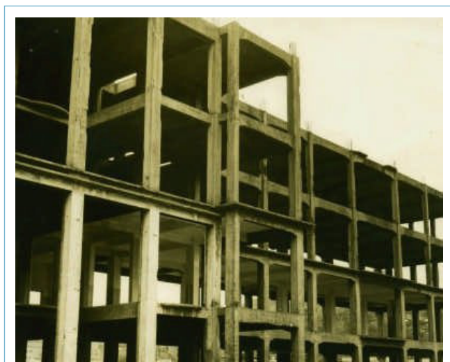
Visão da Edificação Hipotética – Obra Inacabada exposta ao tempo Fonte: Adaptado de http://www.direitouerj.org.br/2005/fdir70/FotosSiteFinal/MID26.jpg
