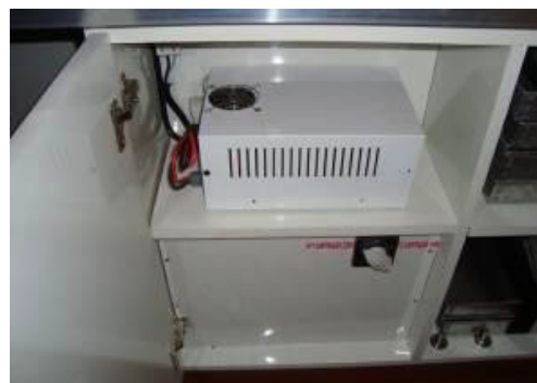
Figura 4 – Conversor de energia elétrica no armário
