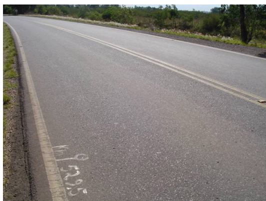
Foto 3 - Início de trecho onde deveria haver remendos profundos
