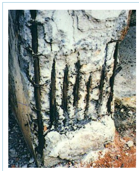
Vista de pilar com deslocamento do concreto devido à corrosão da armadura Fonte: http://patologiaestrutura.vilabol.uol.com.br/home.htm
