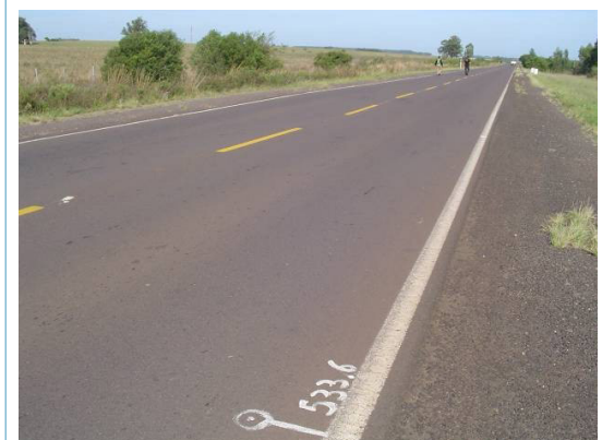
Foto 4 - Final de trecho onde deveria haver remendos profundos
