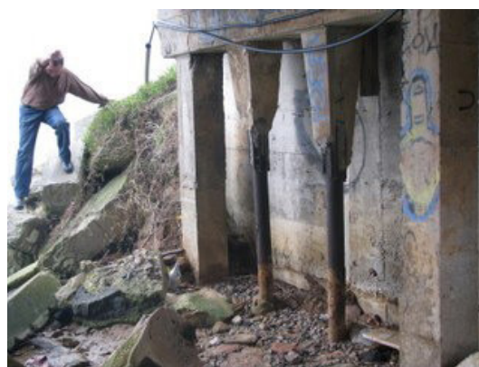
Foto 4: Detalhe dos pilares de concretos "trocados" por metálicos.
