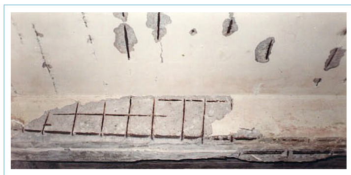
Vista de viga com deslocamento do concreto (face lateral) devido à corrosão da armadura Fonte: http://patologiaestrutura.vilabol.uol.com.br/home.htm
